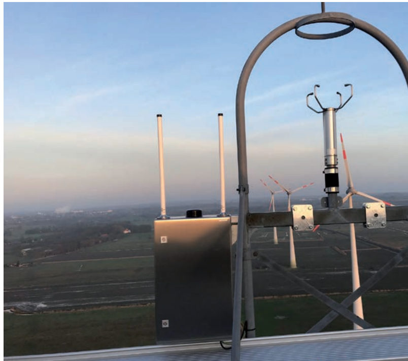
▲ Light:Guard Receiver: Montage auf der Gondel
